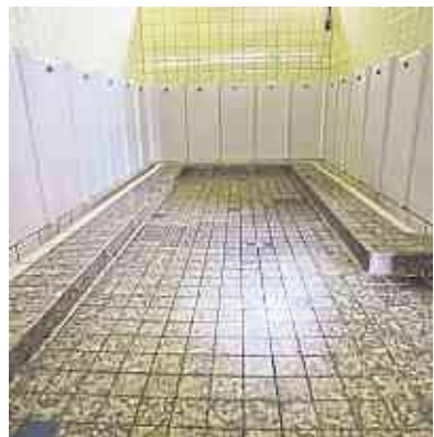
Die alten Toiletten werden nun nicht mehr genutzt. Probleme gibt's trotzdem. Foto: Rühle
